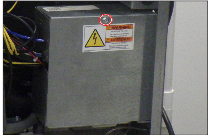
Afb. 1. Locatie van de schroef van de afdekplaat van de schakelkast.
