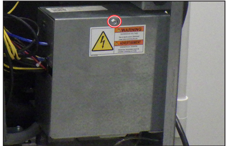
Abb. 1. Position der Schrauben der Schaltschrankabdeckung.
