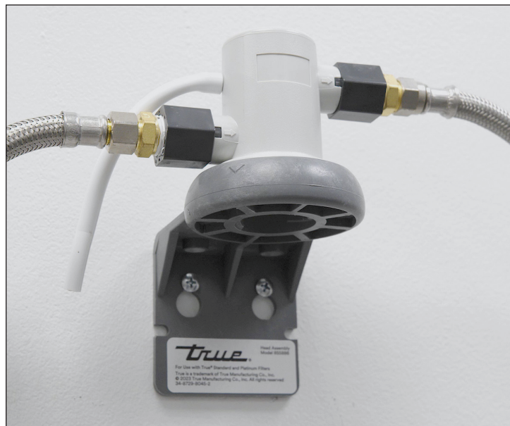
Рис. 2. Фильтрующая головка для воды TRUE установлена на стене и подключена к подводе для подключения к водопроводу.
