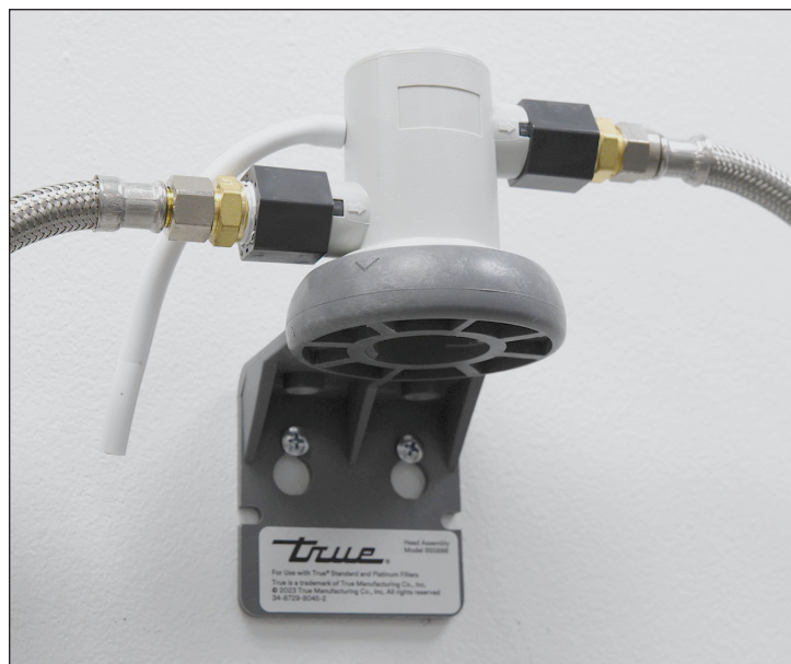
Rys. 2. Filtr wody TRUE zainstalowany na ścianie i podłączony do przewodów doprowadzających wodę.
