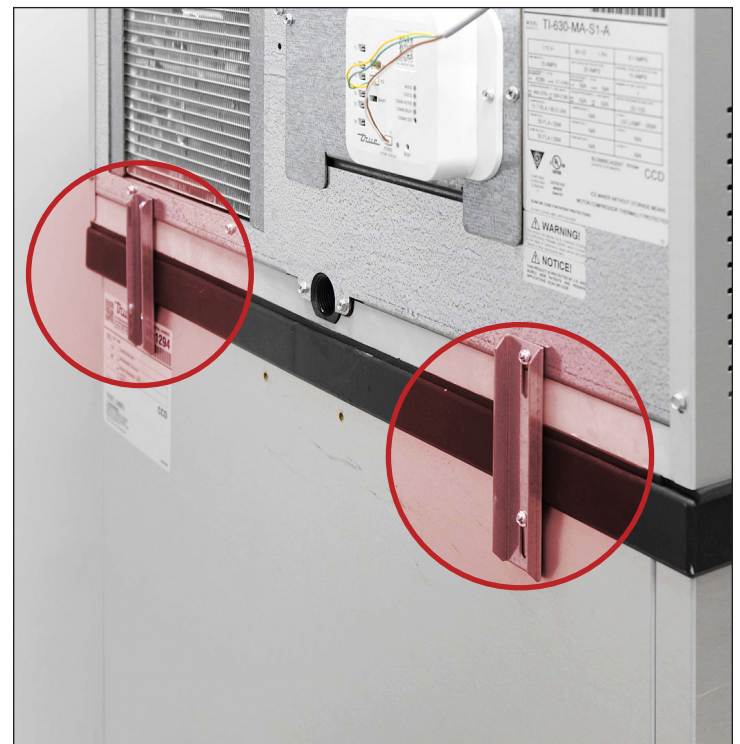
Fig. 8 Staffe del contenitore installate.
