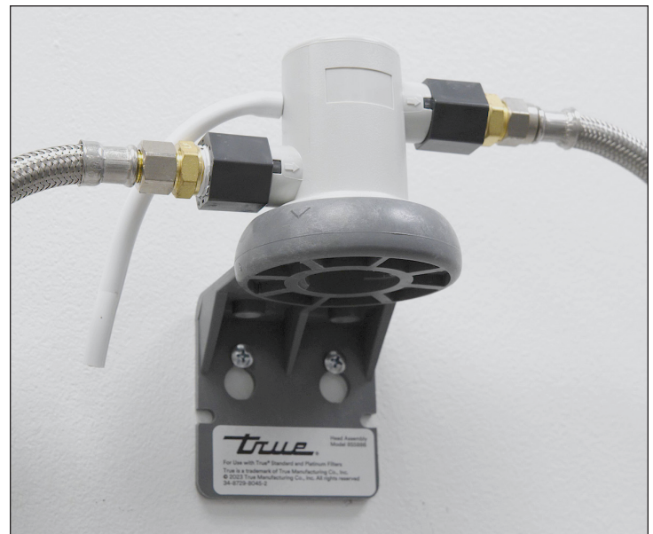
Abb. 2. An einer Wand installierter und an die Wasserversorgungsleitungen angeschlossener TRUE Wasserfilterkopf.
