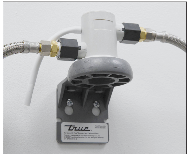
Figure 2. Tête de filtre à eau TRUE installée sur un mur et raccordée aux conduites d'alimentation en eau.
