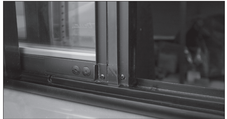
Fig. 2. El pestillo de la puerta está en posición cerrada (desenganchado de la muesca).
