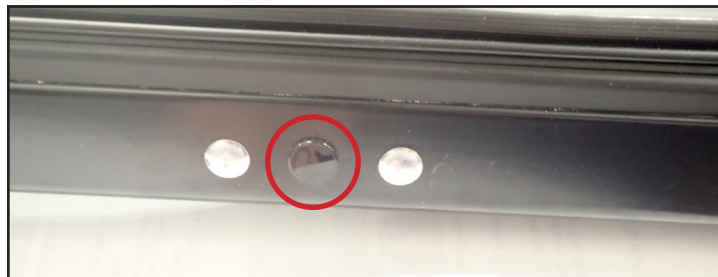
Fig. 22. Capuchon en plastique dans la partie inférieure de la porte.
