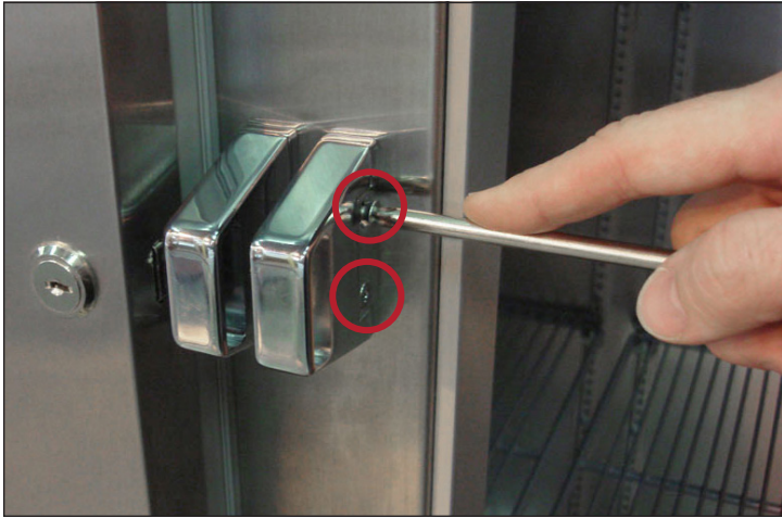
الشكل 5. أماكن مسمار القفل الكهربائي.
