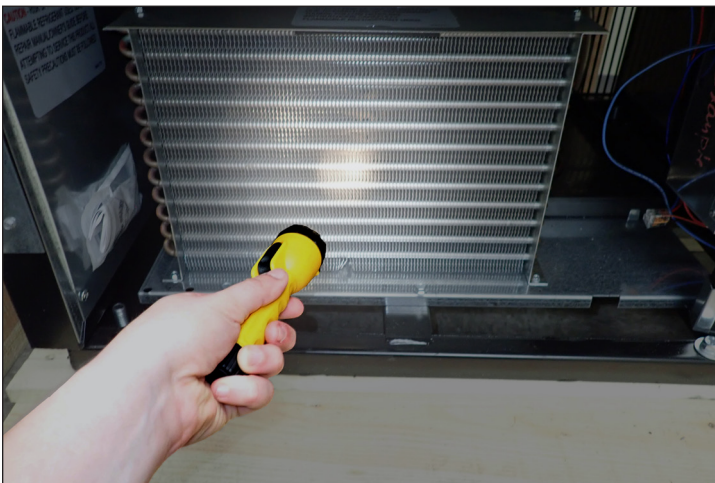
Fig. 3. Utilice una linterna para realizar la inspección y confirmar que el serpentín está limpio.
