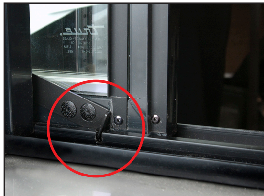
Image 1. Le verrou de porte est en position ouverte (engagé sur l'encoche).
